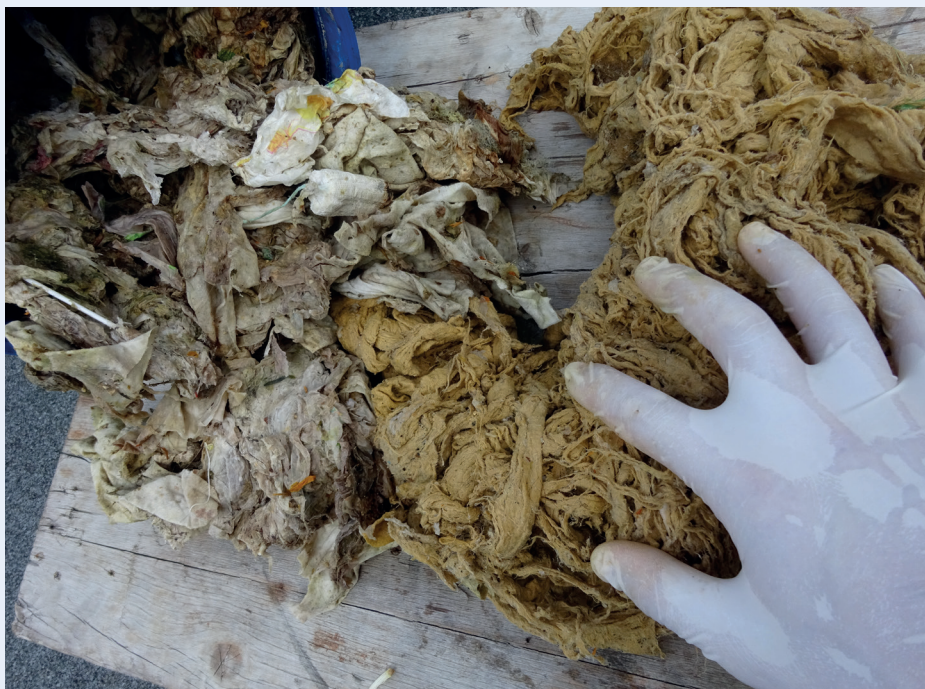
Verzopfungen aus der Pumpstation.
